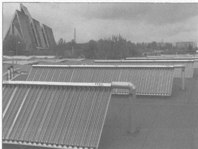
Zespół próżniowych kolektorów słonecznych na dachu budynku Katedry Inżynierii Energii
