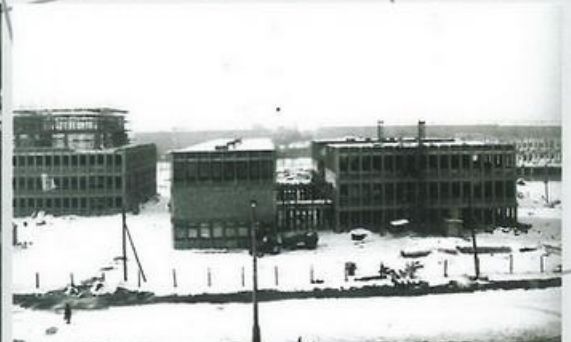
Do budowy kompleksu pawilonów przy obecnej al. Armii Krajowej przystąpiono w drugim kwartale 1968 roku. W 1970 roku wybudowano trzy pawilony w stanie surowym
