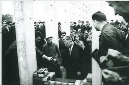
Akt erekcyjny podpisano i kamień węgielny wmurowano w fundamenty budynku w dniu 10 października 1968 r.
