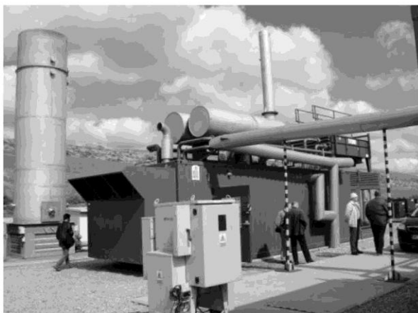
Biogazowy zespół kogeneracyjny z silnikiem GE JENBACHER JMS 316 GS-B.LC 828 kW e /870 kW e w Oczyszczalni Ścieków WARTA S.A. w Częstochowie (od góry) i kontener z jednym z zespołów prądowców z silnikiem gazowym CAT 3516 1150 kW e wchodzących w skład małej elektrowni biogazowej na wysypisku odpadów CzPK w Sobuczynie k. Częstochowy (na dole)
