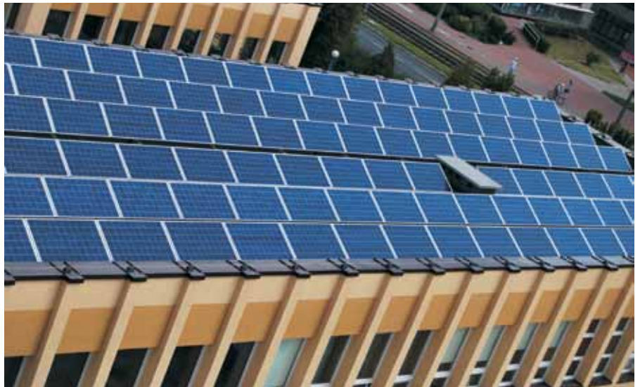
Ogniwa fotowoltaiczne na dachu budynku Wydziału
